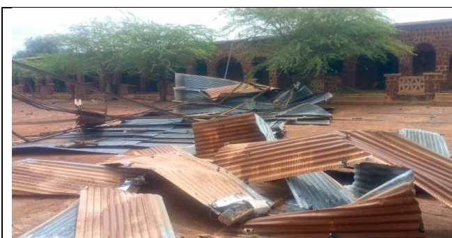
Dégâts au Lycée Yadega
