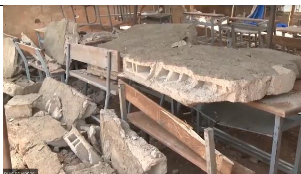
Dégâts au secteur 1 de la commune de Fada N'Gourma
