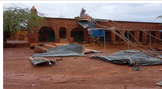
Toits du Lycée Yadega à Ouahigouya décoiffés
